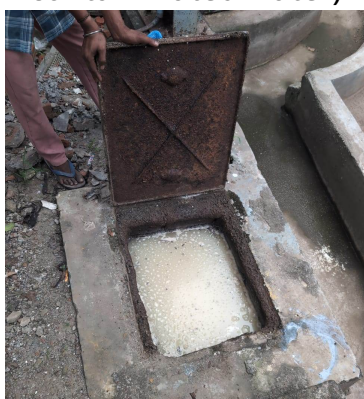
Pharma plant effluent collection u/g chamber.
